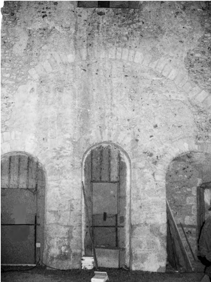
Fig. 9 : La tour-porche de Saint-Père de Chartres : vue intérieure de la salle haute, avec les trois baies ouvrant sur la nef.
