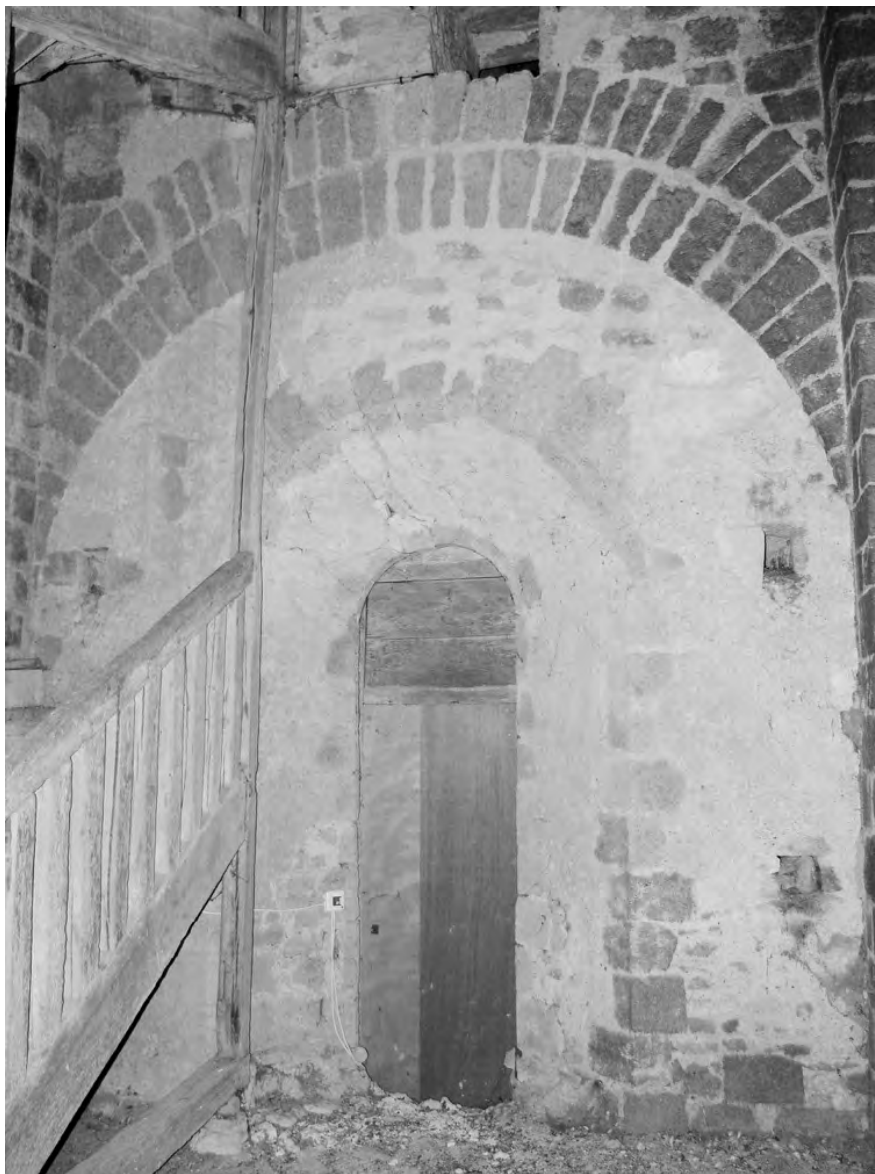
Fig. 11 : La tour-porche de Mareau-aux-Bois : arcade à double rouleau de la salle haute donnant autrefois sur la nef (réduite ensuite à une porte).
