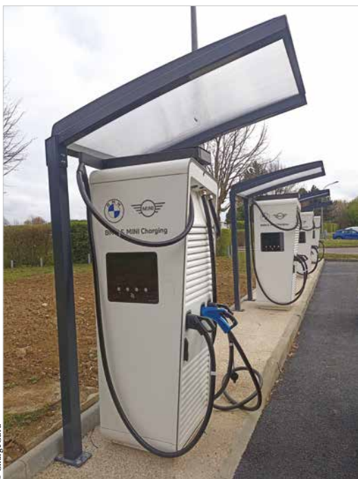
Bornes BMW installées par ChargeGuru.
