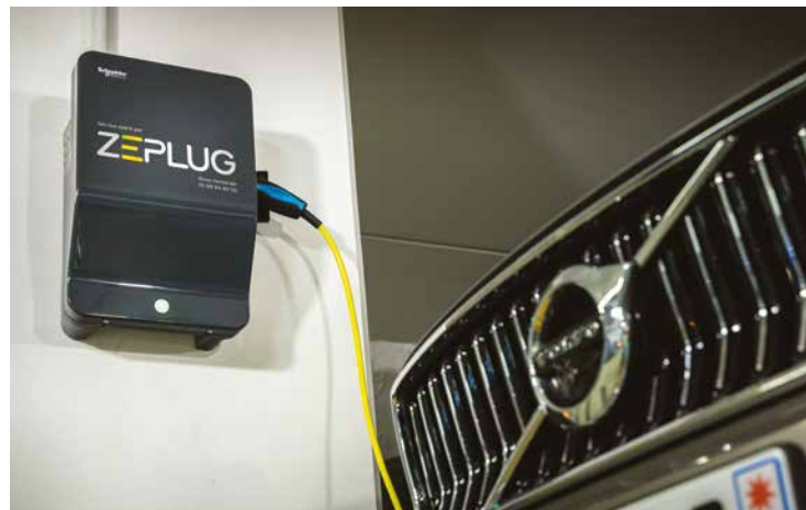
Borne de recharge Zeplug installée dans le parking d'une copropriété.
