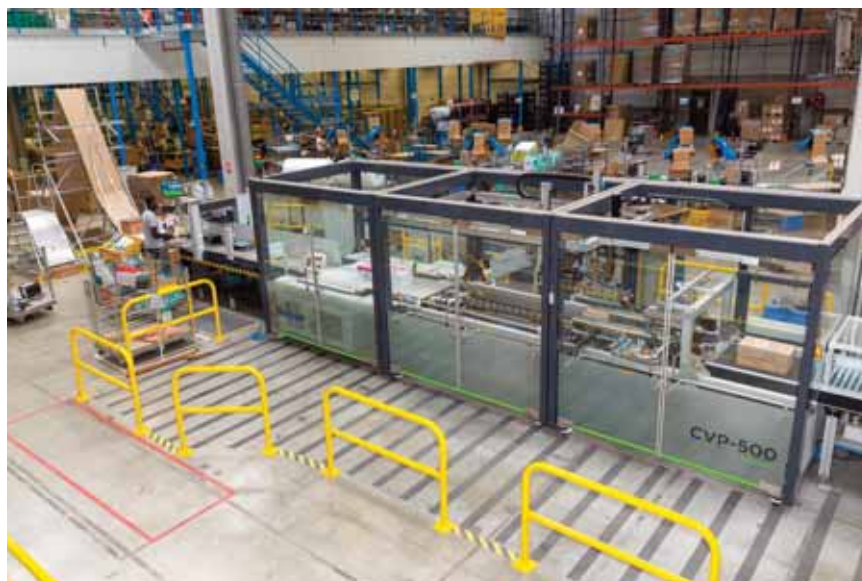
Une des emballeuses 3D – entrepôts de Cestas
